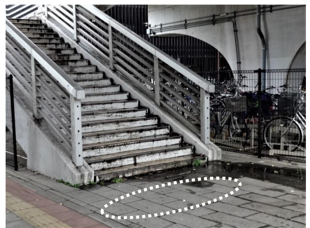
写真 21. 階段の終わり(白の点線箇所)に警告ブロックが設置されていない階段(つくば駅周辺)
