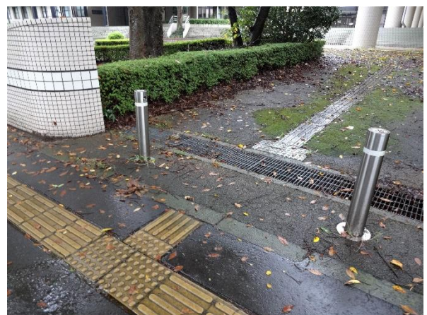
写真 3. 歩道の誘導ブロックと施設内の誘導ブロックが接続していない (筑波技術大学前)
