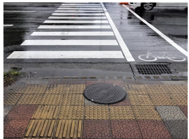
写真 27. マンホールの部分に警告ブロックが設置されていない箇所(万博記念公園駅前)
