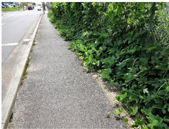
写真 23. ブロックの上に草が覆いかぶさっている箇所(みどりの駅周辺)
