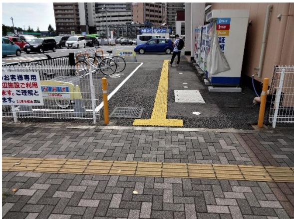
写真 5. 歩道の誘導ブロックと施設内の誘導ブロックが接続していない(研究学園駅周辺)
