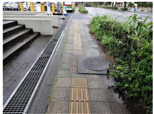
写真 26. マンホールによって途切れている誘導ブロック(つくば市内)
