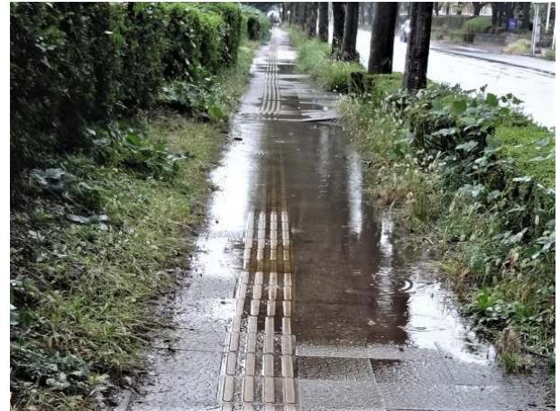
写真 25. ブロックの上に雨水がたまっている箇所(つくば市内)
