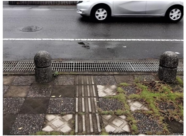
写真 19. 車道に向かって設置されている誘導ブロック(つくば市内)
