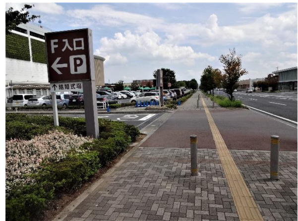
写真 1. 駐車場出入口となる歩道に車の通り道を示す警告ブロックが設置されていない (研究学園駅周辺)
