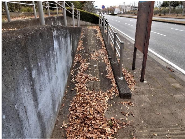
写真 22. スロープの上に誘導ブロックが設置されている箇所(つくば市内)
