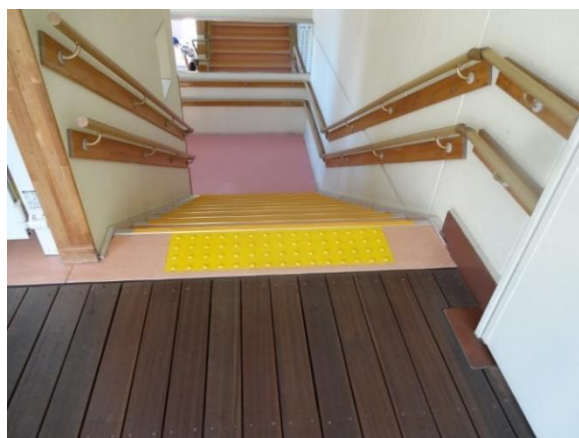
写真1. A幼稚園の階段の点字ブロック
