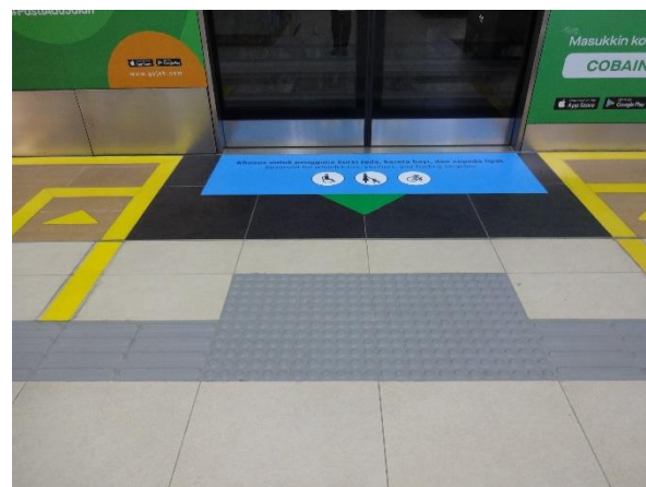
写真3. 乗降口の部分の2列の警告ブロック。電車の乗降口から2mの距離があるため、車いす使用者などのバリアにはなっていない。
