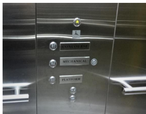
写真 20. エレベータ内の操作ボタン
