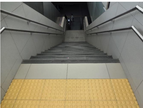
写真 24. 踊り場には点字ブロックがない
